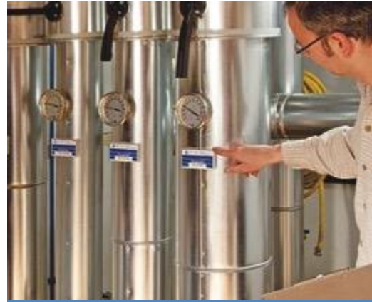
Kommunale Gebäude und Anlagen
