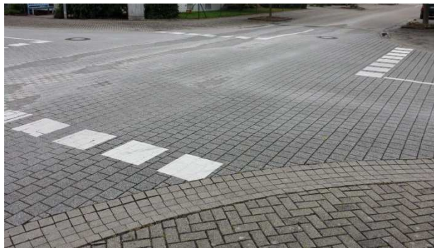
(Schäden an der Kreuzung Rathaus-/Westl. Brühlstraße)
